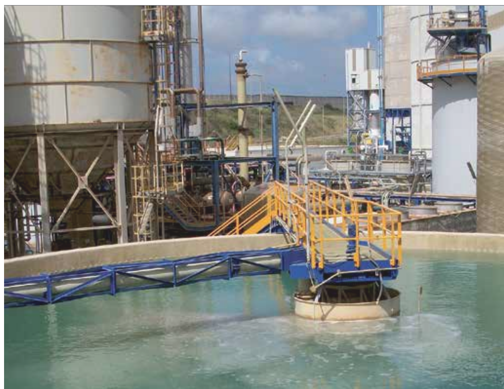
Impianto trattamento acque
